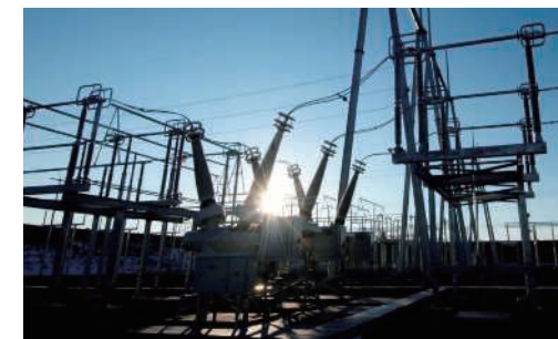
TXNM Energyの変電所
