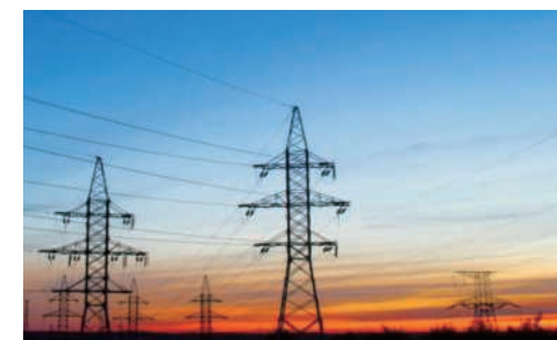
TXNM Energyの送電網
